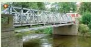
Most s ocelovou rámkou a železnou trubkou na hradech ve vodě železný záchyt, místo zastřešení vody.
