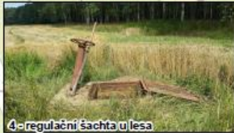
4 - regulační šachta u lesa
