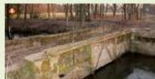
Stavěná u mostu se zdvihacím strojem, jsou zastřešena na regulační matici.
